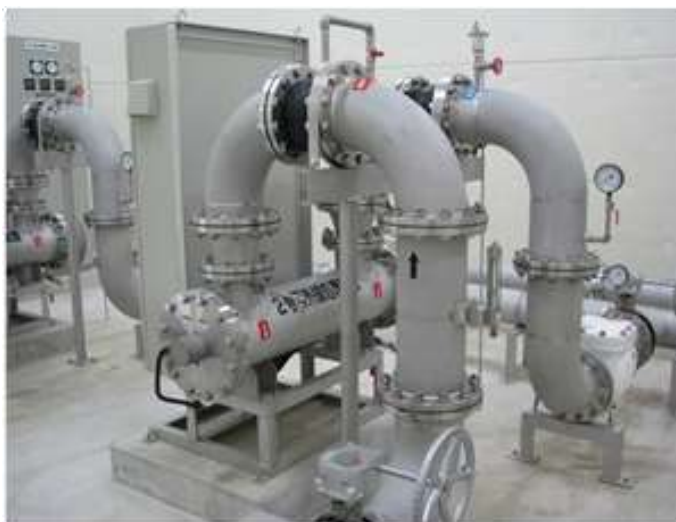
【クリプトスポリジウム等対策（紫外線照射設備）】
