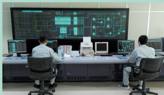
集中監視装置（現在）河頭浄水場
