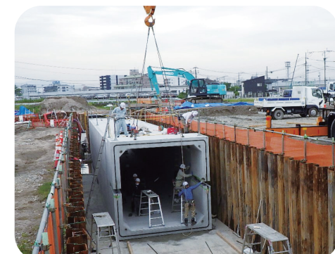
【雨水管きょの布設工事】 浸水被害の軽減を図るための布設替えや老朽化した既設管きょの長寿命化対策を進めています。
