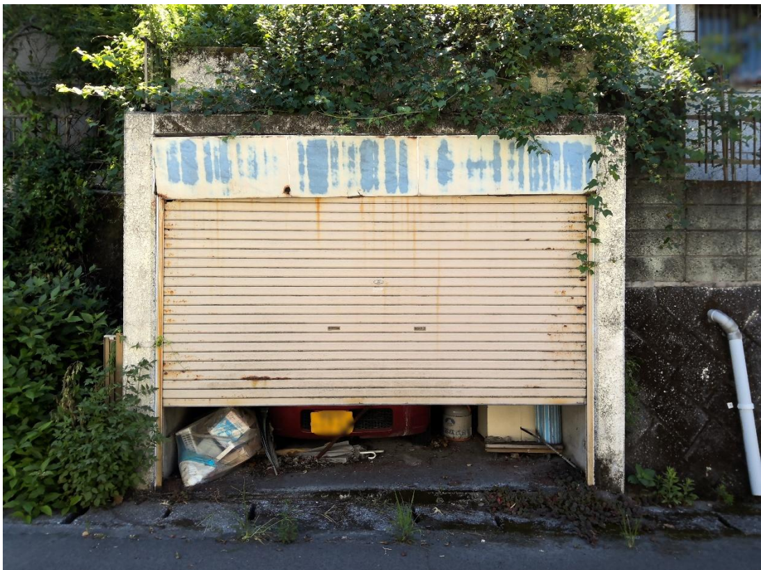
車庫（シャッターは一部破損しています）
