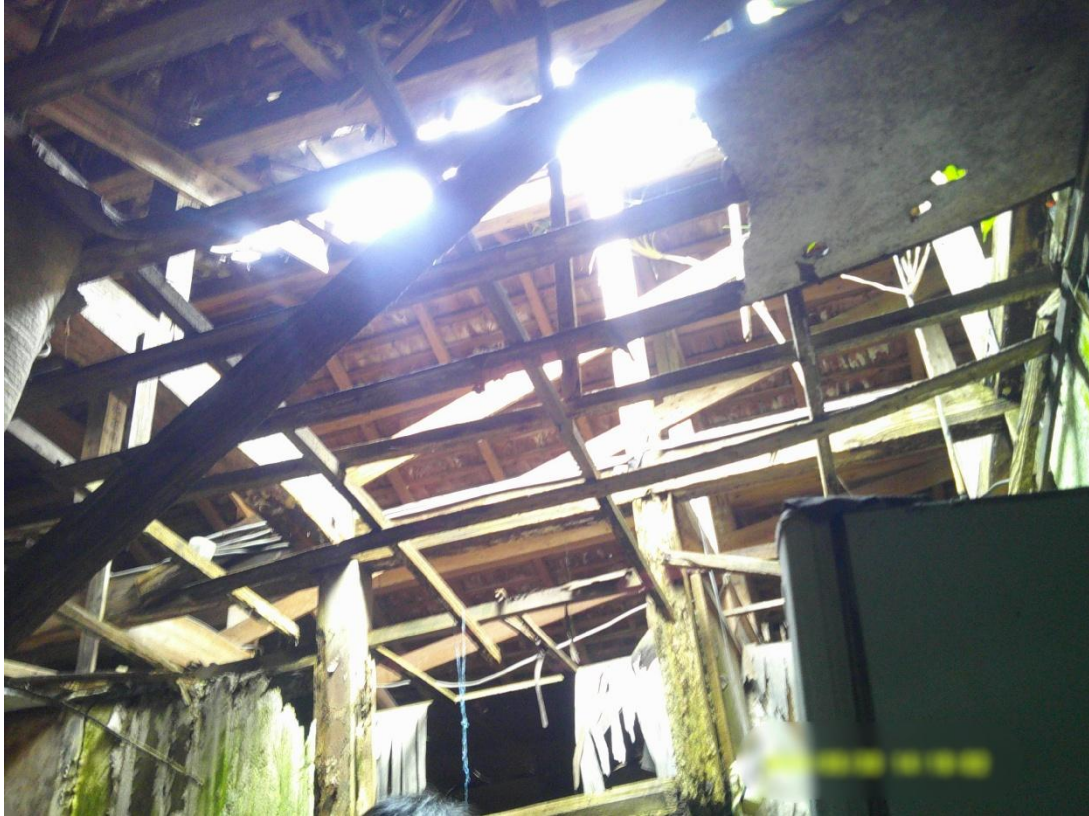
居宅の屋根部分が崩落しています
