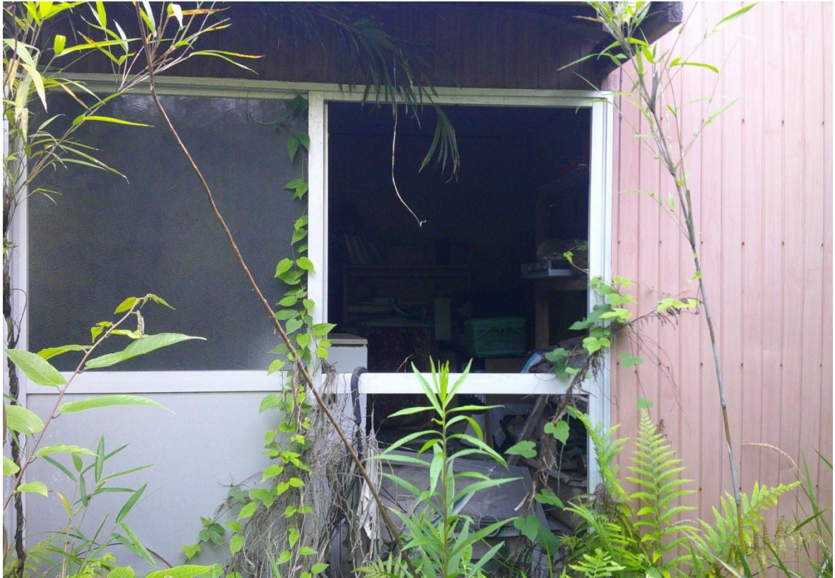
倉庫（入口の引戸が破損しています）
