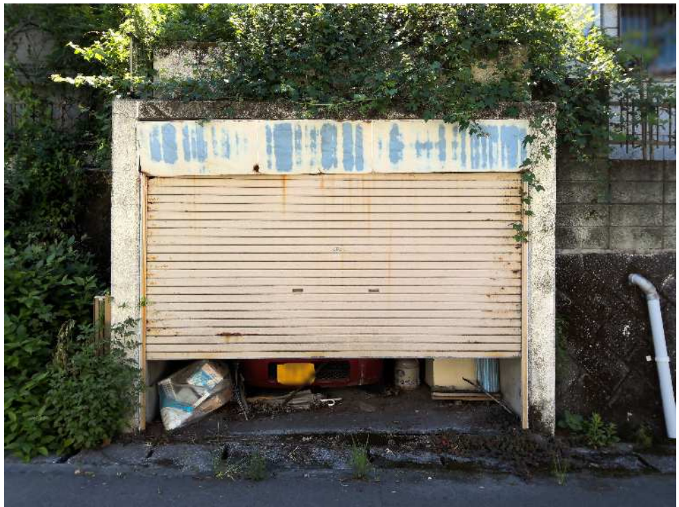
車庫（シャッターは一部破損）
