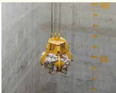
2 ごみクレーンおよびピット
