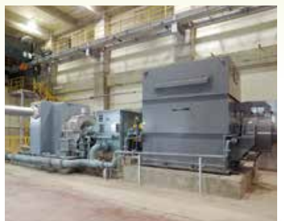
6 蒸気タービン・発電機
