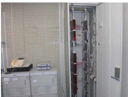
老朽化した電話交換機
