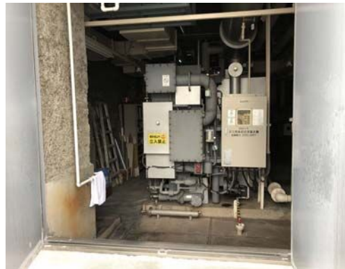
ガス吸収式冷温水機
