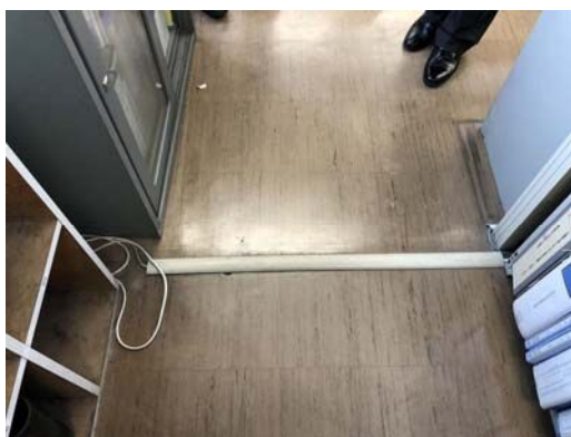
配線カバー（配線モール）の突出
