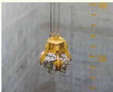
2 ごみクレーンおよびピット
