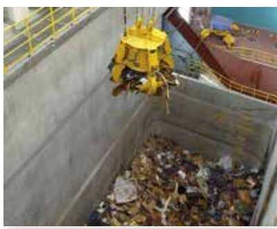
2 ごみクレーンおよびピット
