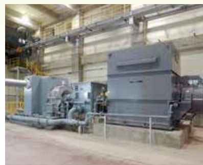
6 蒸気タービン・発電機
