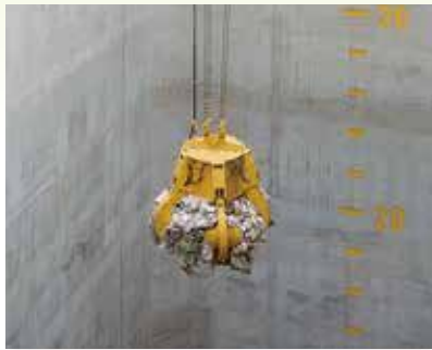
2 ごみクレーンおよびピット
