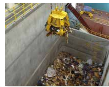
② ごみクレーンおよびピット
