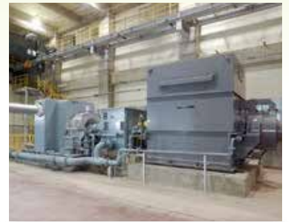
6 蒸気タービン・発電機
