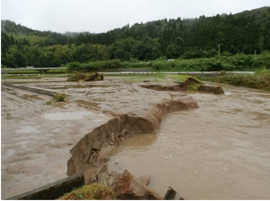
《集中豪雨による被害状況》
