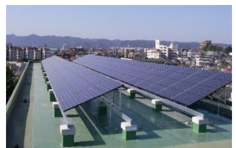
市有施設の太陽光発電システム
