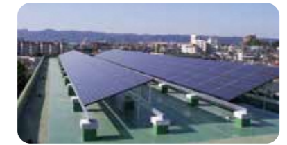
市有施設の太陽光発電システム
