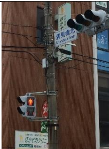
経過時間表示機能付灯器（清見橋北口）の設置 （谷山地区：平成 28 年度整備箇所）
