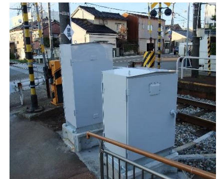
踏切制御装置
