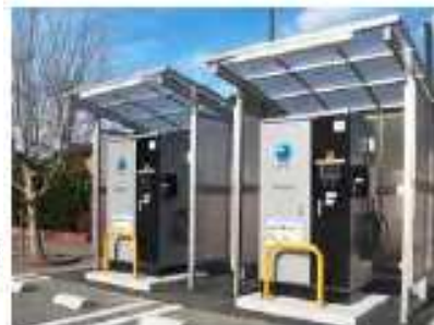
充電施設 蓄電池
