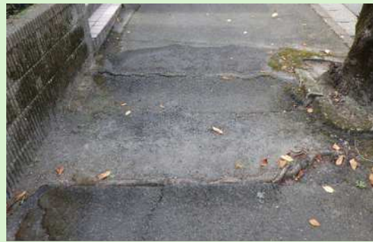
【根による舗装の隆起状況】
