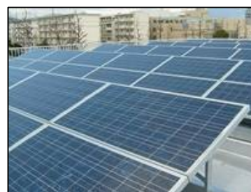
太陽光発電設備
