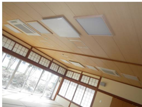
窓からの採光により消灯
