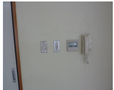
和田福祉館 空調リモコン
