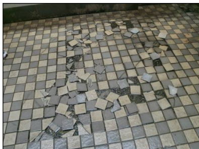
舗装の剥がれ
