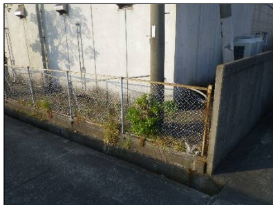
金属製フェンスのさび
