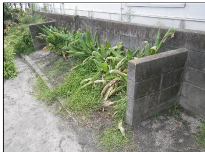
コンクリートブロック塀の傾斜
