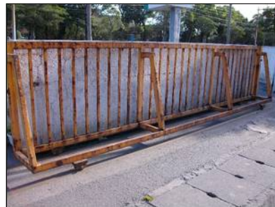
鋼製門扉のさび
