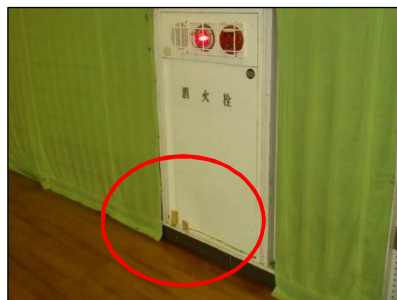
消火栓 BOX 歪み
