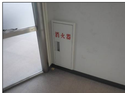
消火器収納箱
