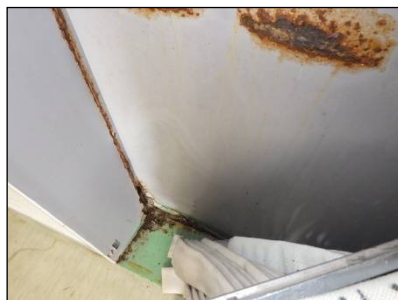
消火栓 BOX さび付き
