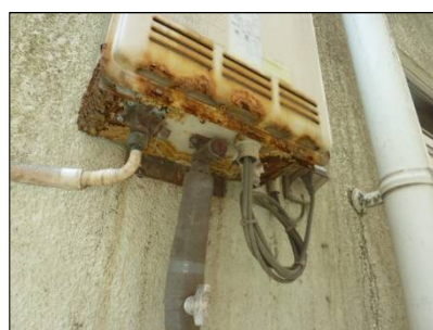
給湯器のさび
