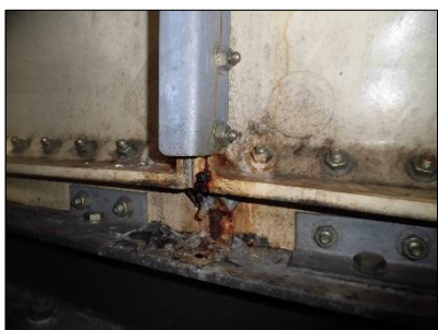
水槽からの漏水
