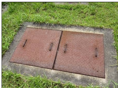
浄化槽蓋の腐食
