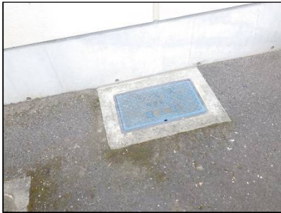
水道メーターボックス
