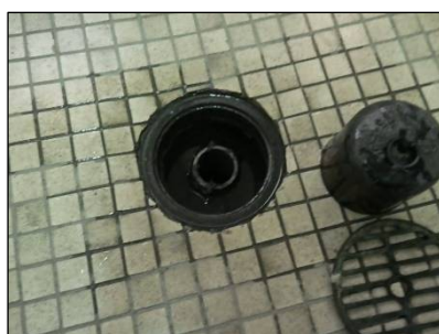
床排水口汚れ
