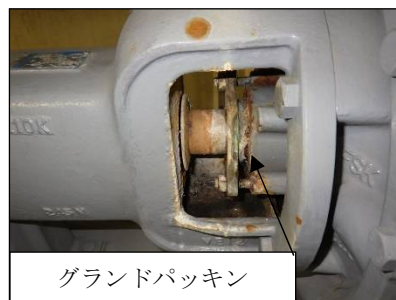
ポンプのグランドパッキン
