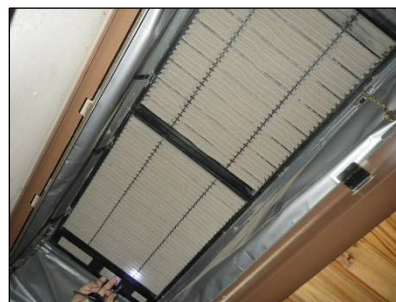
室内機フィルターの詰まり
