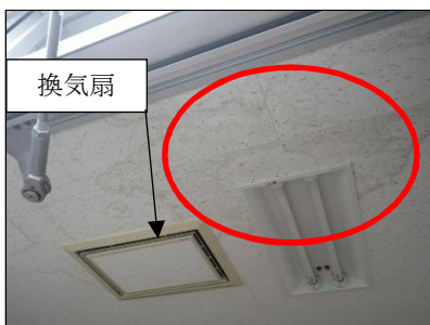
換気ダクトからの漏水跡
