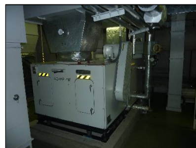
エアハンドリングユニット
