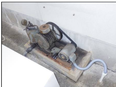
ブロワーの劣化
