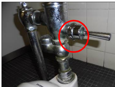
フラッシュバルブからの漏水
