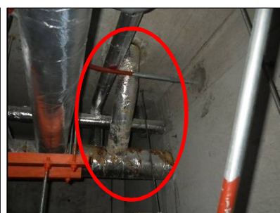
排水管の漏水痕
