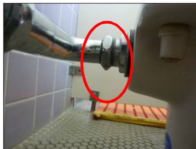
洗浄管の漏水
