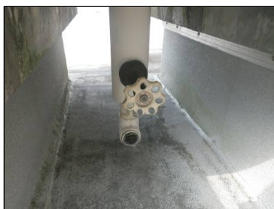
防虫網の破損
