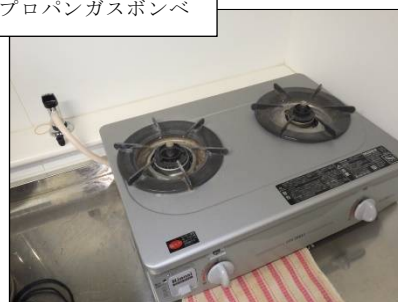
ガス栓及びガス機器
