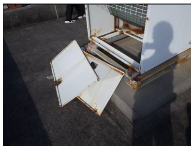
室外機外板飛散
