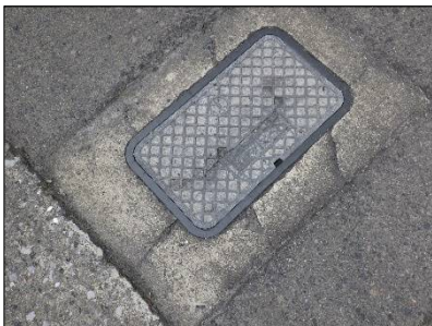
ボックス蓋破損
