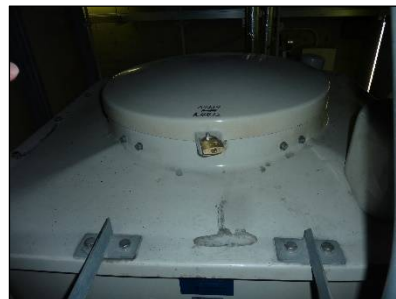
点検蓋の施錠
