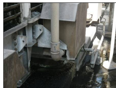
冷却塔からの漏水
