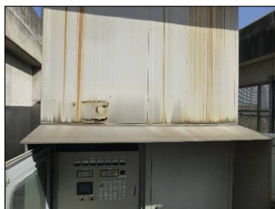
外装の腐食・穴あき
