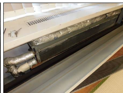
ファンコイルユニットの腐食
