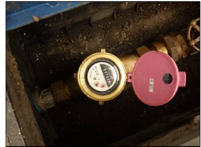
水道メーター
