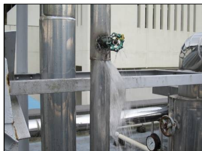
給水管の漏水
