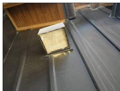
排気フードが目詰まり
