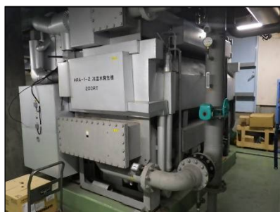
冷温水発生器
