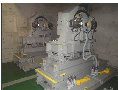
エレベータ巻上機
