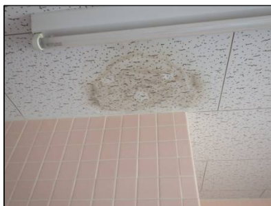
天井の漏水痕跡
