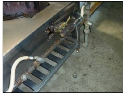
ガス器具周り配管のさび
