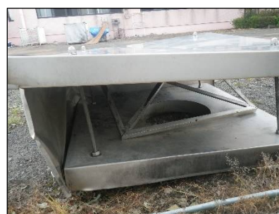
煙突の傘落下
