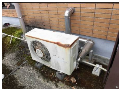
室外機のさび発生状況
