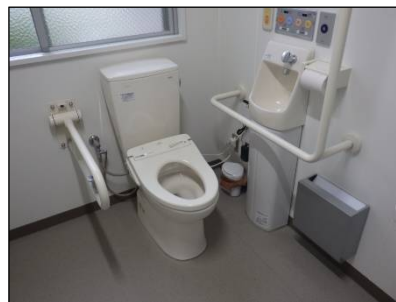
衛生器具 (多目的トイレ)
