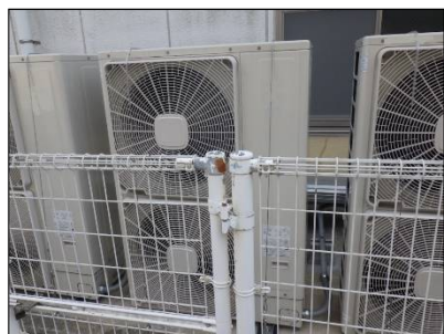
エアコン室外機
