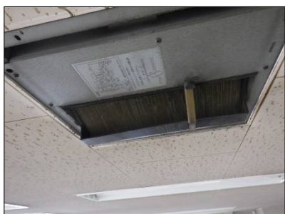
フィルターが目詰まり
