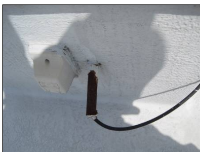
電線管の腐食
