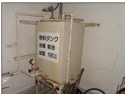
燃料槽の腐食
