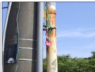
引込電線管の腐食
