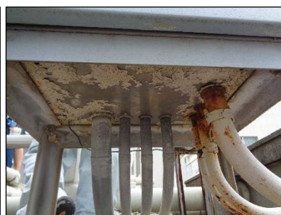
電線管の腐食
