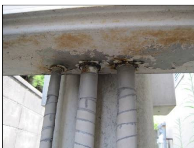
電線管の腐食
