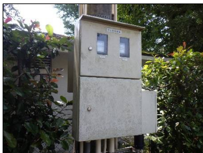
引込開閉器盤
