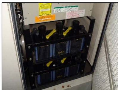
始動用蓄電池の劣化
