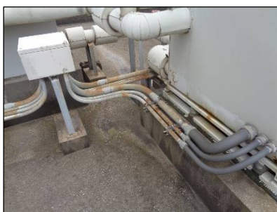
電線管の腐食
