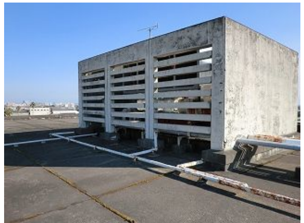
■外壁剥離等が見られる管理棟
