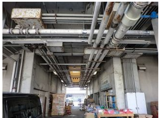
■外壁剥離等がみられ照度が不足している関連商品売場棟
