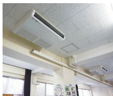
理科室に設置している空調設備
