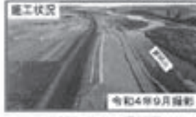
施工状況 令和4年9月撮影 ⑨ 常陸大宮市大塚地区 （大塚池水地）
