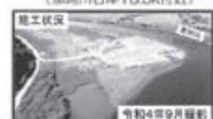
施工状況 令和4年9月撮影 ⑬ 水戸市渡里地区 （那珂川右岸17.0k付近）
