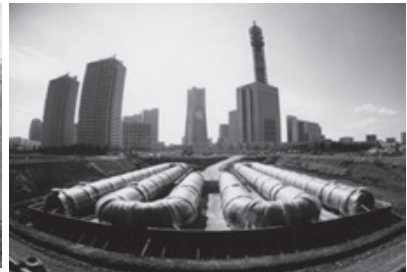
災害用給水タンク（上図③）
