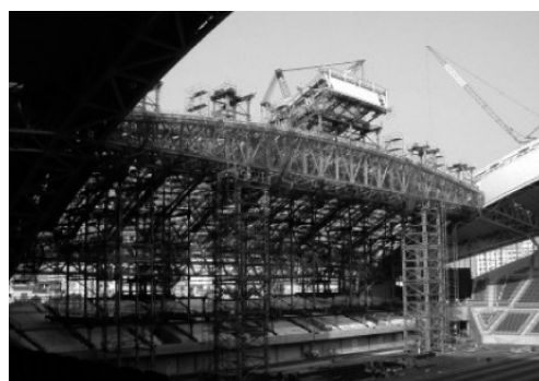
開閉式の屋根が設置される（第2期工事） （出典：ノエビアスタジアム神戸HP）
