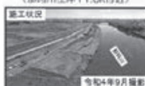
施工状況 令和4年9月撮影 ② 水戸市中野内地区 （那珂川左岸14.5k付近）
